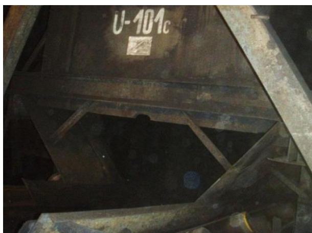
Rys. 2. Obudowany przesyp przenośnika stalowo-członowego nr U-101C [7]
